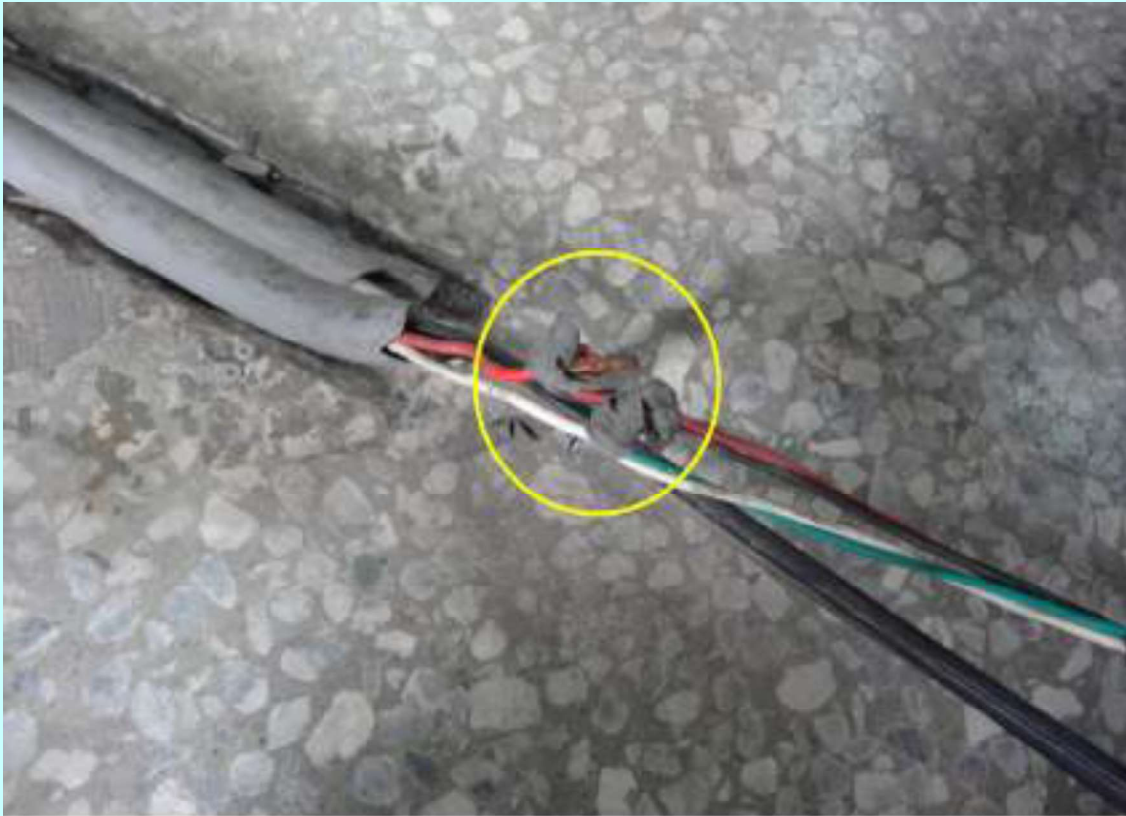
照片 2 地面插座電線裸露之情形
